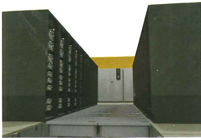
Obr. 2: Přisun chladného vzduchu k rackům je potřeba od příkonu 5 kW/rack začít přesněji řídit
